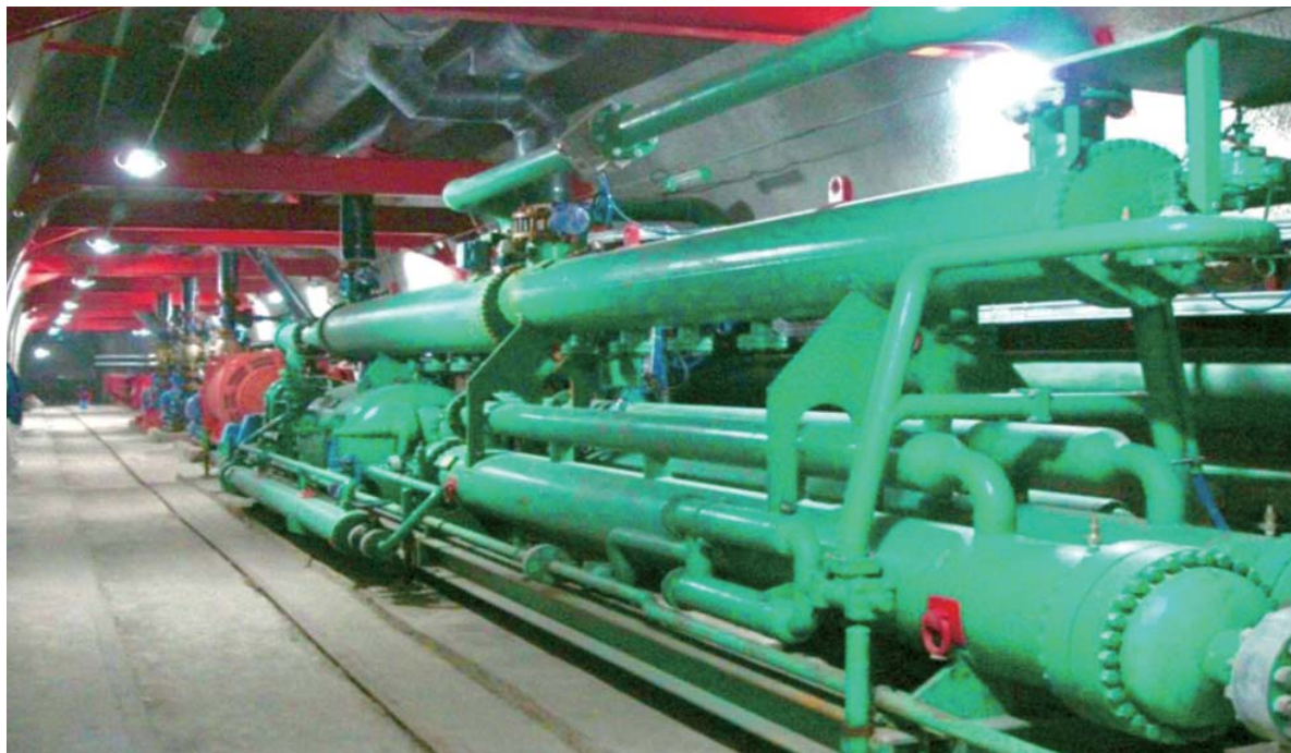
山东能源兖矿能源集团公司赵楼煤矿 5 台 KM3000 井下集中式矿用防爆制冷装置：总制冷功率为 16500 kW
