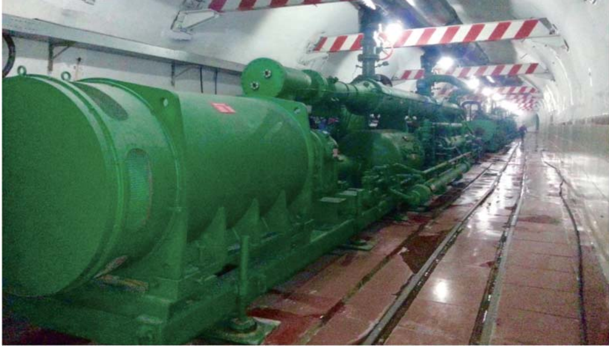
山东能源鲁西矿业有限公司郭屯煤矿 5 台 KM3000 井下集中式矿用防爆制冷装置：总制冷功率为 16500 kW
